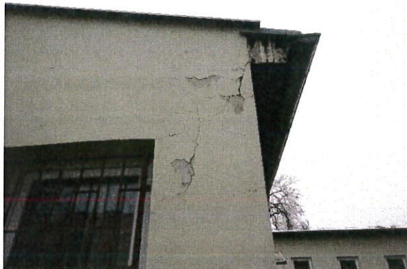
Foto č. 17 – 24 – poruchy v objektu
